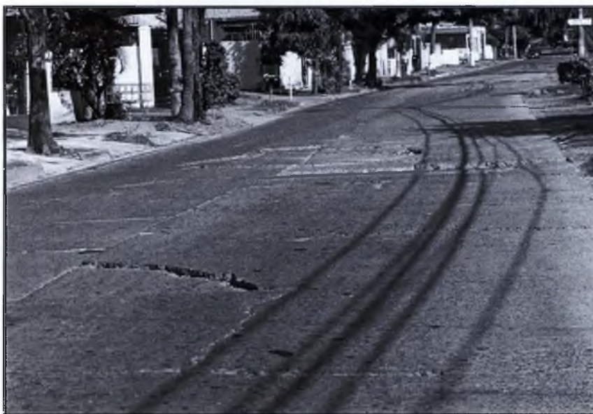
Foto N° 18: Calle en mal estado (Urb. Los Robles Sur)
